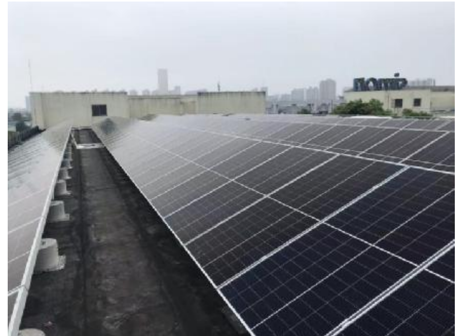
建立屋面光伏电站使用清洁可再生能源
