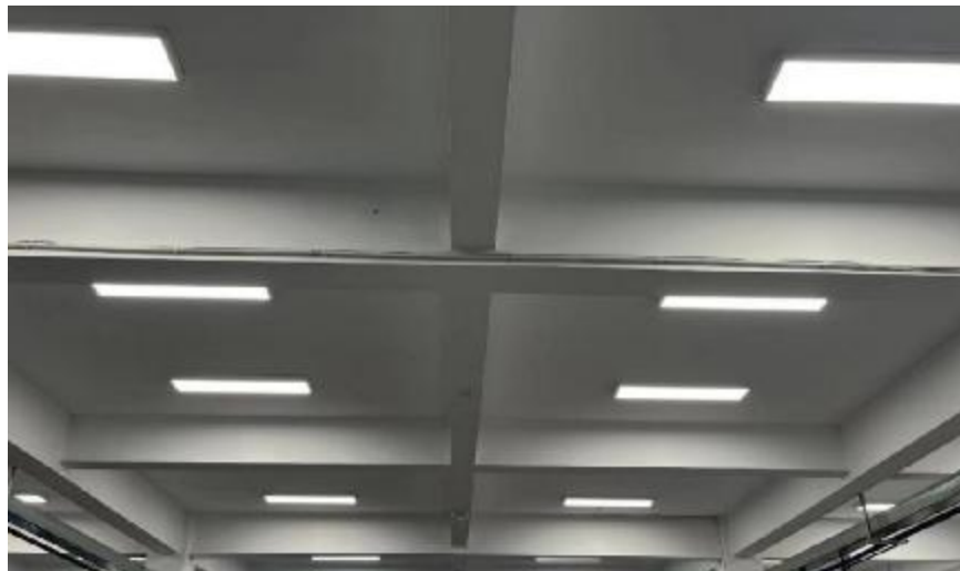
采用 LED 照明灯具节约能源
